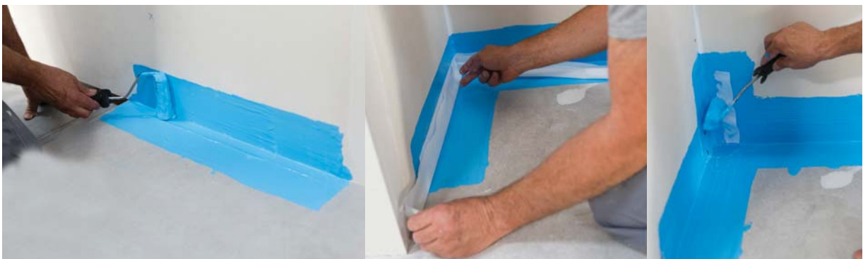
Fig. 5 - Protection des pieds de cloison avec le SPEC Knauf Étanche : Application d'une 1 ère couche de produit dilué. Après séchage, application d'une 2 ème couche de Knauf Étanche non dilué et mise en œuvre de la bande Knauf Étanche. Puis, application d'une dernière couche de Knauf Étanche non dilué.
