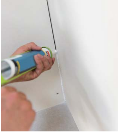
Fig. 3 - Traitement des cueillies, des angles rentrants et des points singuliers à l'aide d'un mastic sanitaire label SNJF
